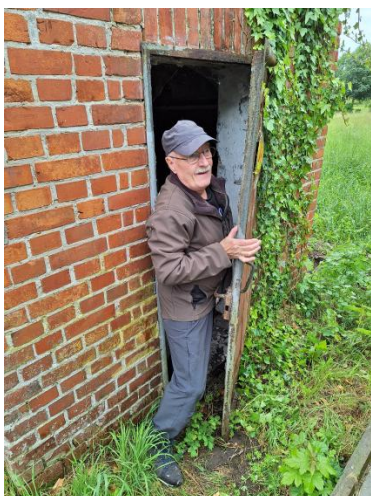
Abb. 4: Immer wieder klemmte mal eine Tür wie hier am Trafo in
